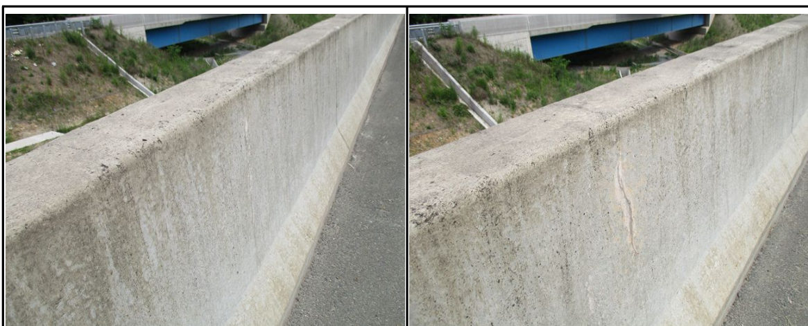
상행선 S1 균열 CW=0.1mm
